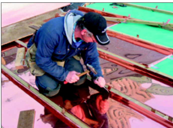
Pose des panneaux en cuivre de la toiture utilisant des outils manuels.
