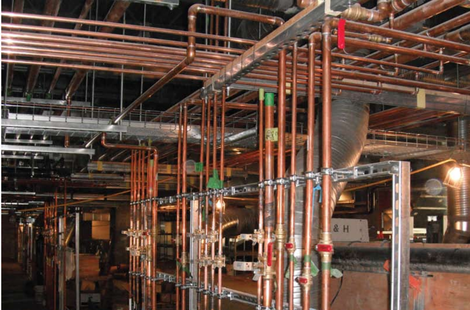
Pose soignée de tubes de cuivre dans le plafond et des descentes verticales dans un espace intercalaire.
