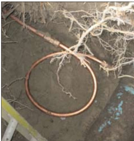
Le travail terminé au niveau de la canalisation d'eau. The completed installation at the water main.
